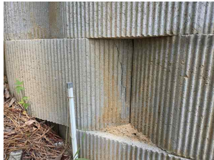
<옹벽 하단 블록 균열>
